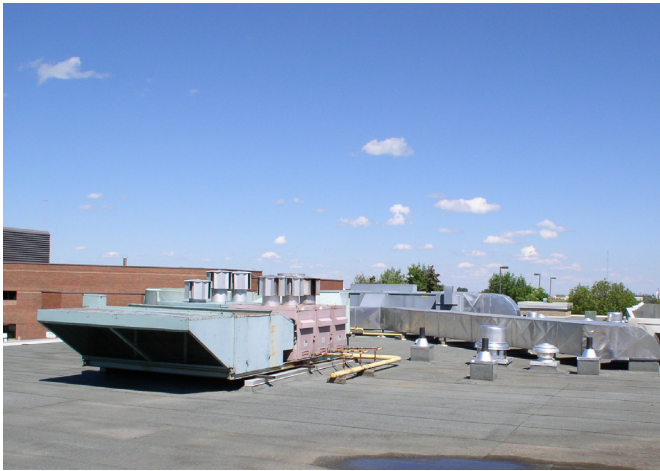
Photo 1 - Les toits sont parfois des espaces encombrés où des prises d'air côtoient des colonnes de ventilation
