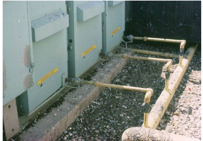
Photo 2 - L'enlèvement de la fiente est rendu difficile par le lest contre cette prise d'air
