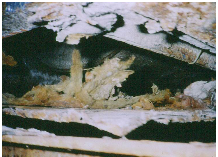
Photo 5 - Le fond de l'enceinte de ventilateur est perforé par la rouille à cause d'une fuite de l'humidificateur
