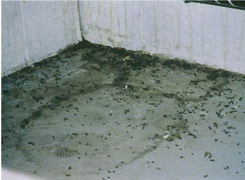
Photo 3 - On peut voir que ce local technique, qui sert aussi de plénum de reprise d'air, a été mouillé par l'humidité qui entre à partir de la prise d'air adjacente. Il est aussi contaminé par de la matière organique.
